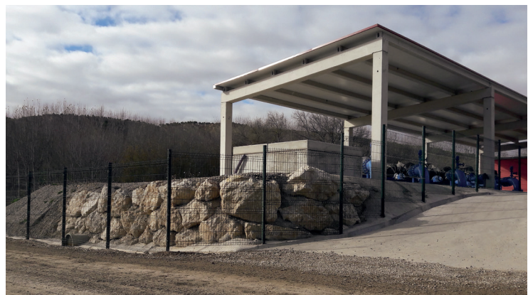
Figura 17. Estación de bombeo en Funes (Navarra).
