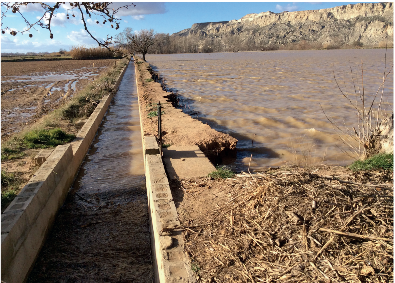
Figura 40. Daños provocados por una avenida en una acequia (Utebo).
